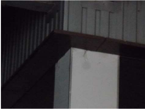
北側の建物玄関の飛来箇所
