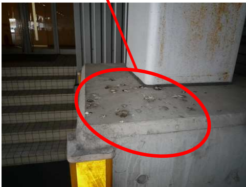
南側建物の玄関付近にも糞害が発生
